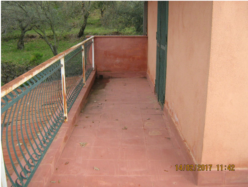
FOTO N.35 –FINE TERRAZZO A PERIMETRO LATO OPPOSTO
