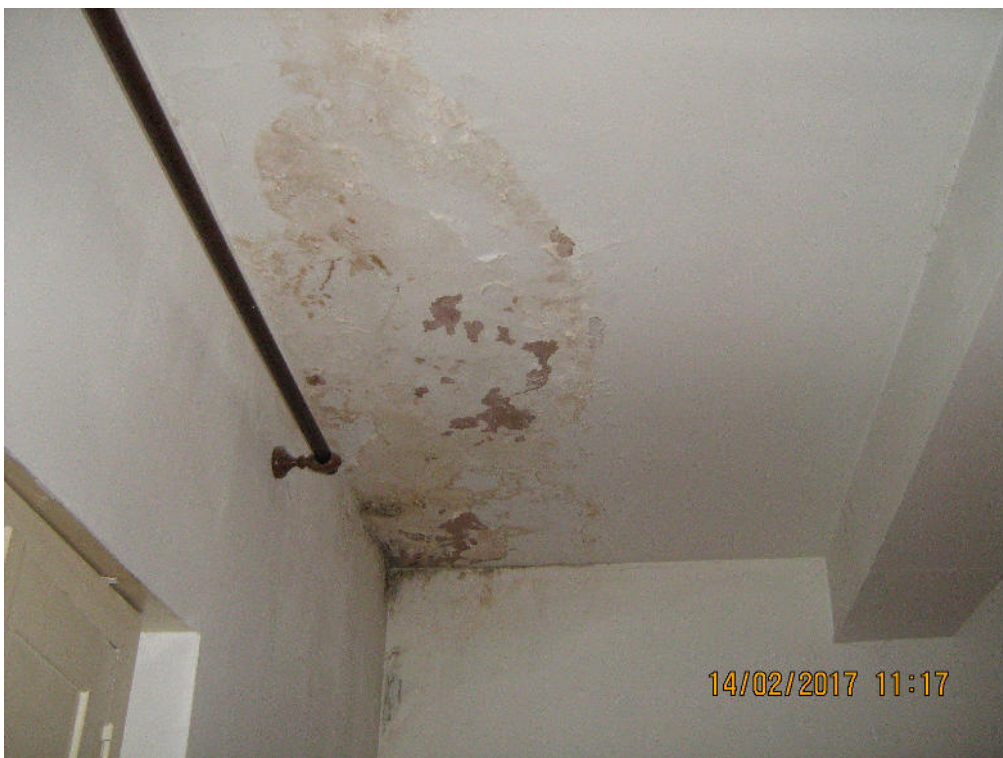
FOTO N.20 – STANZA DA LETTO (infiltrazioni al soffitto)
