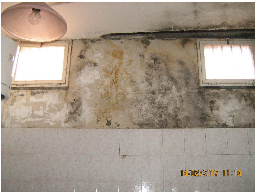
FOTO N.22 – BAGNO (infiltrazioni alla parete finestrata)
